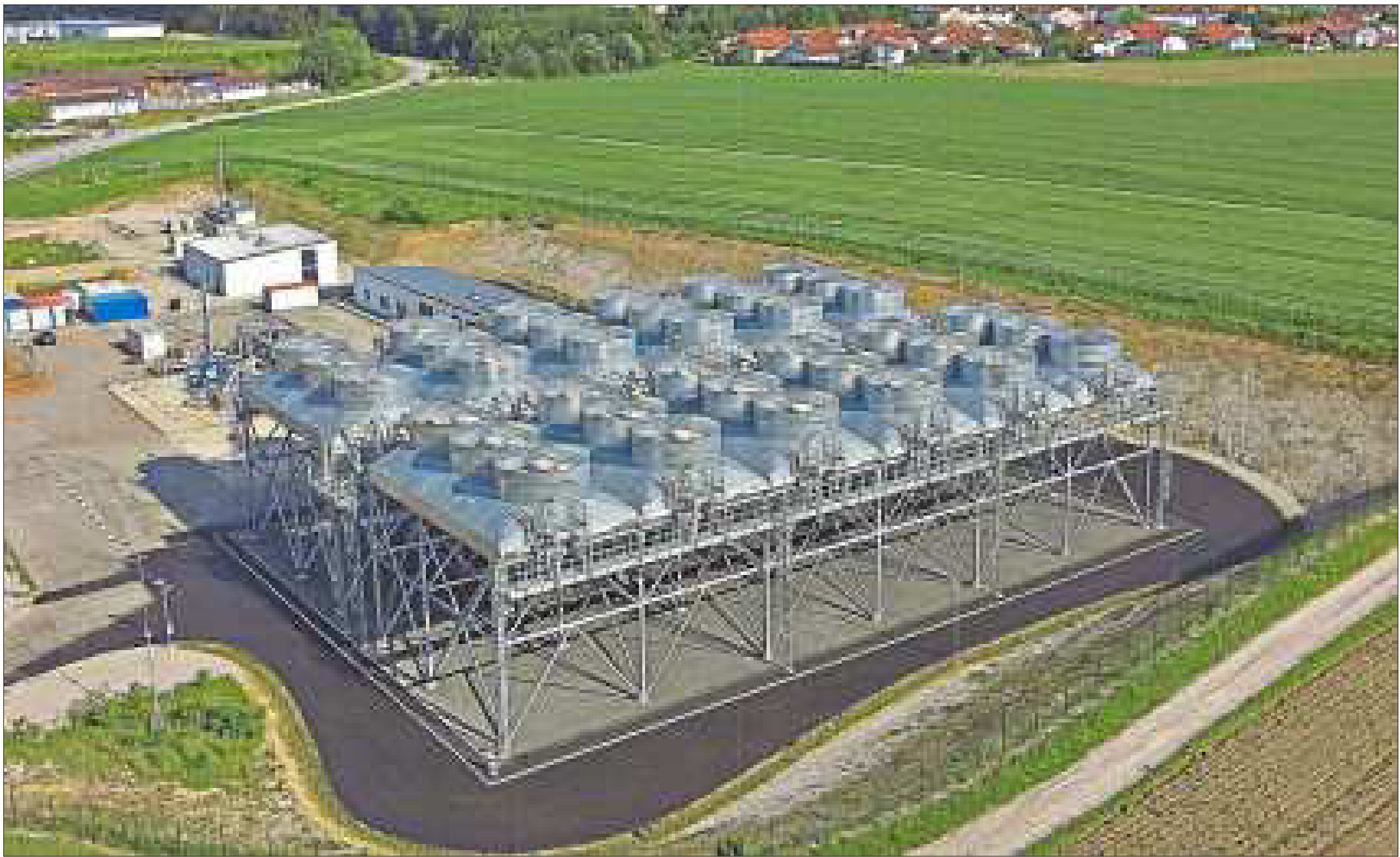
Ein markanter Blickfang der Traunreuter Geothermieanlage ist die Kühlung mit ihren 36 Lüftern. Diese sind auf einem Metallgerüst in gut zehn Metern Höhe angebracht, um möglichst viel Luft ansaugen zu können. – Foto: Stadtwerke Traunreut
