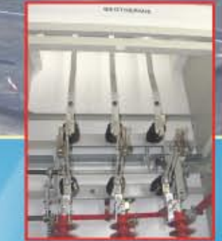
Das neue Schaltfeld.
