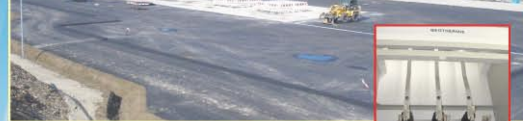
Im Oktober 2011 vom Bergamt Südbayern abgenommener Bohrplatz, in der Mitte das Fundament für die Bohranlage.
